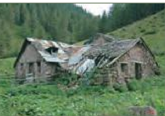
Valbonina , Berzo Inferiore: copertura con scandole e lamira prima del restauro
